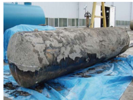
老朽化した地下タンク
